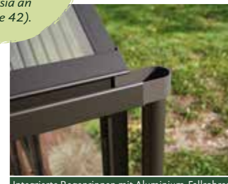
Integrierte Regenrinnen mit Aluminium-Fallrohren
