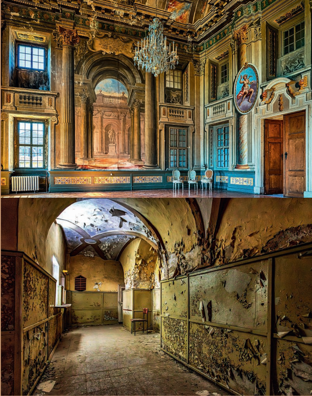
SCHEIN UND SEIN Der Saal von Schloss Crossen (oben) beeindruckt mit Illusionsmalerei. Der Gesamtzustand des Gebäudes ist jedoch schlecht, wie in zahlreichen Durchgängen zu sehen ist
